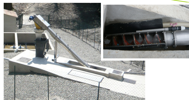
le dégrilleur ensacheur compacteur automatique
